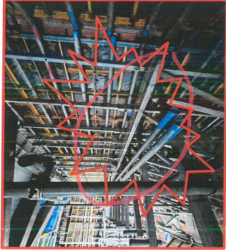
슬져 상부 작업시 승가로 및 발판 설치 불량
