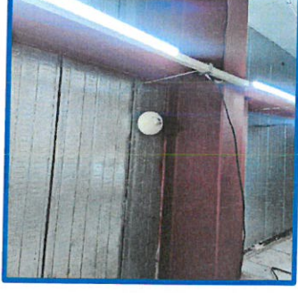
확산소화기 설치 확인
