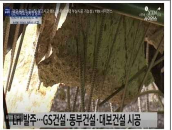
파괴로 인한 콘크리트 박락
