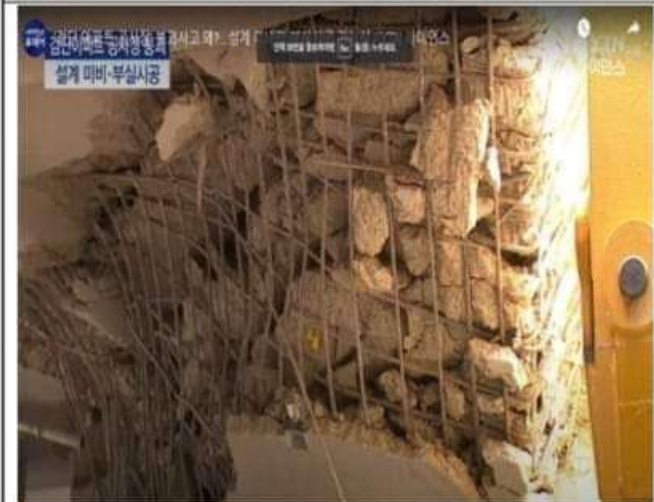
파괴로 인한 콘크리트 박락
