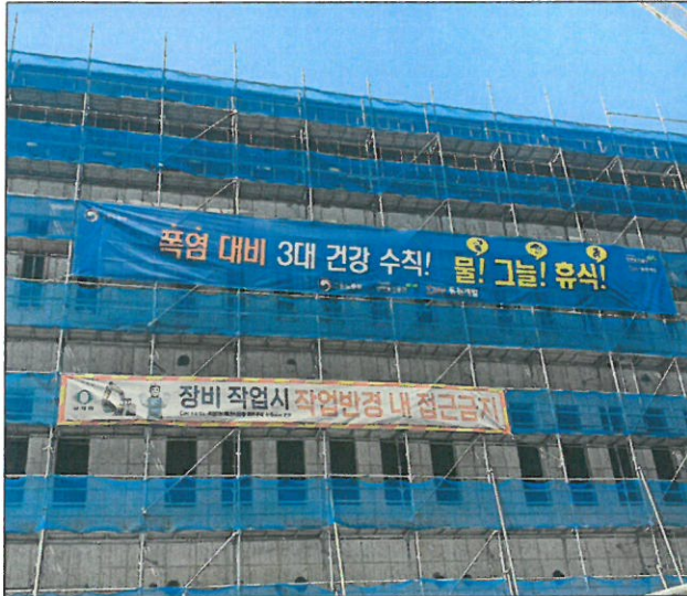
현장 내 흑서기 대비 현수막 게시
