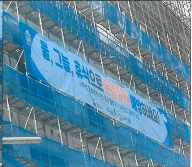
현장 내 흑서기 대비 현수막 게시
