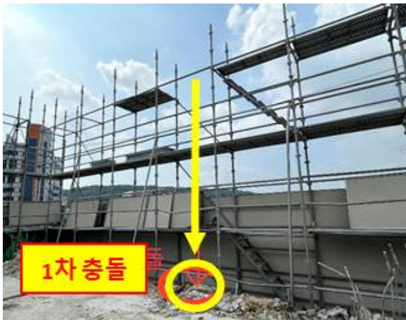
[사진1] 사고발생 장소 전경
