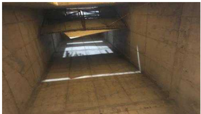
[사진2] 재해발생(무너진 낙하물방지망 하부) 장소
