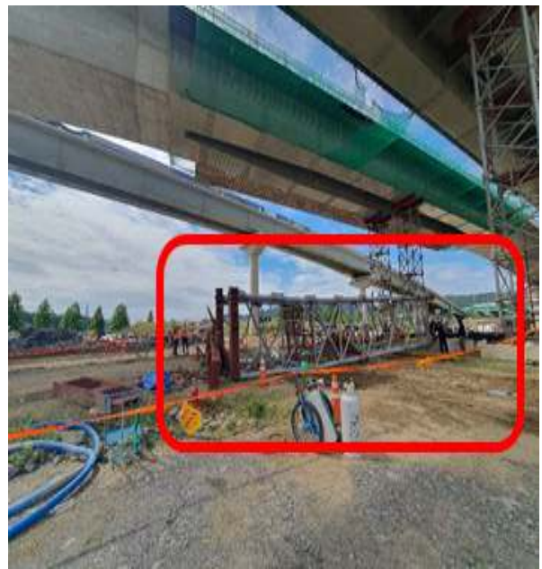
[사진2] 재해발생 장소 전경2
