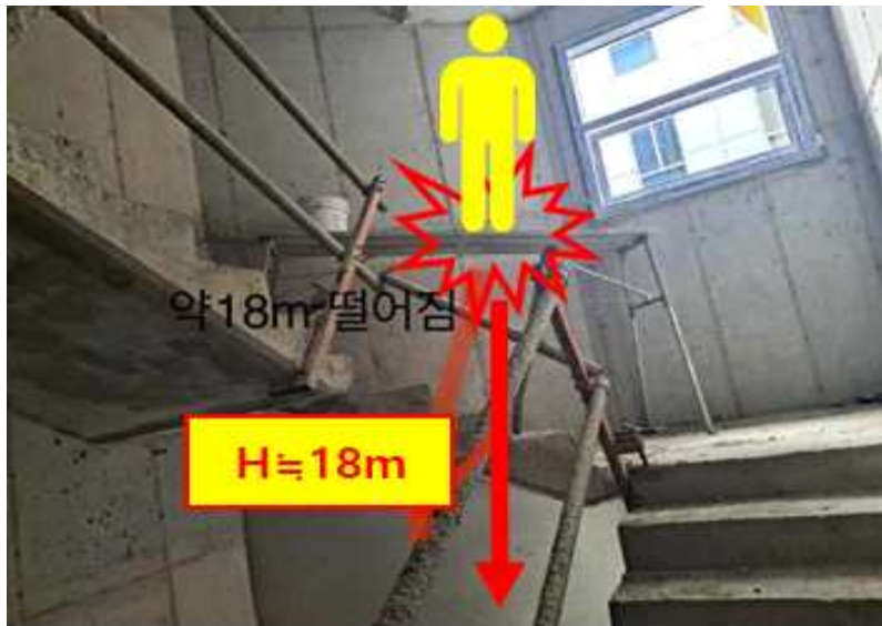
[사진] 재해발생 장소 전경 및 상황도
