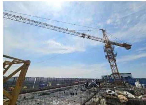
[사진2] 사고 타워크레인 전경2
