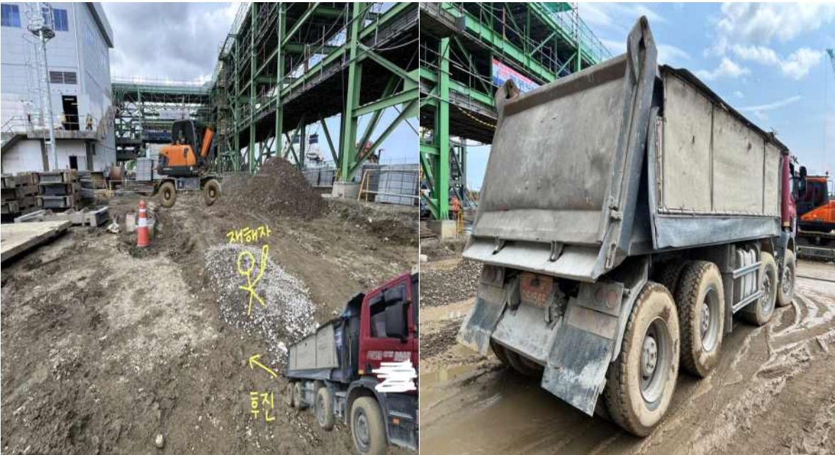
[사진1] 사고 전경
