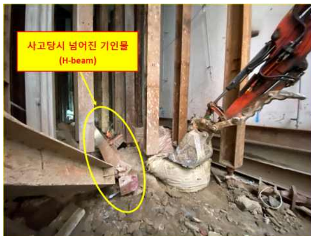
[사진1] 재해발생 장소 전경
