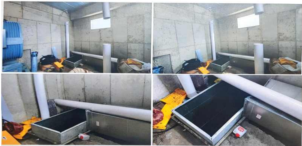
[사진] 재해 발생 장소(공조덕트 내부)
