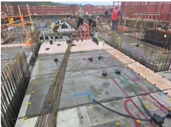
[사진1] 사고발생 장소 전경
