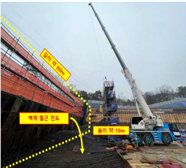
[사진1] 재해현장 전경1
