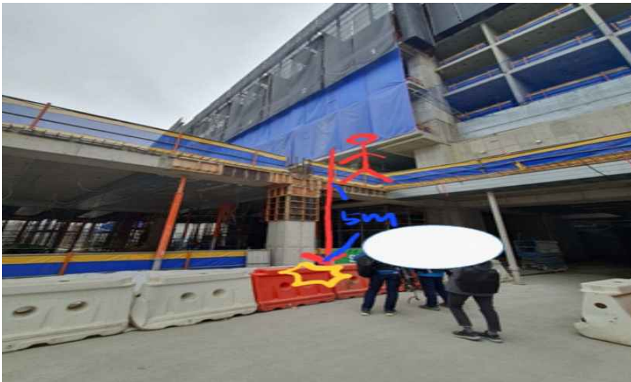
[사진] 재해발생 장소 전경 및 상황도
