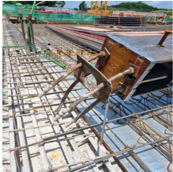
[사진2] 사고 기인물(기둥 기초앵커 탈락)
