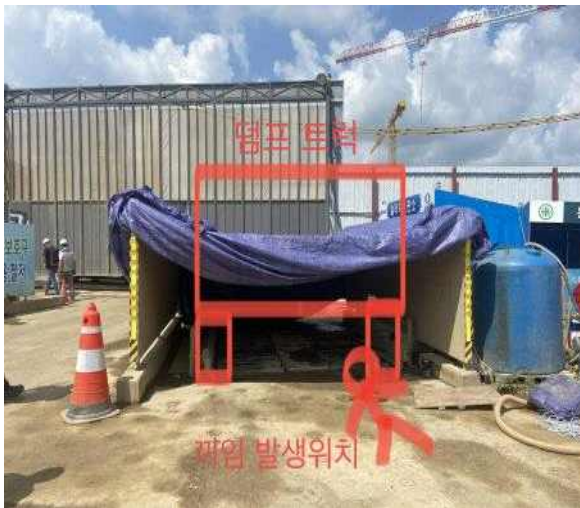
[사진1] 재해 발생구간 전경
