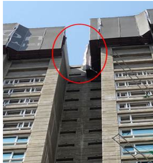
[사진2] 탈락한 갱품 위치 전경
