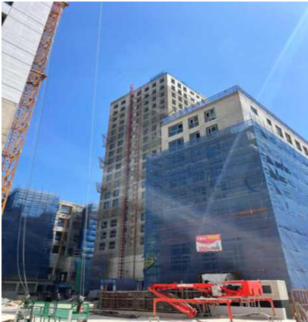
[사진1] 재해발생 현장 전경
