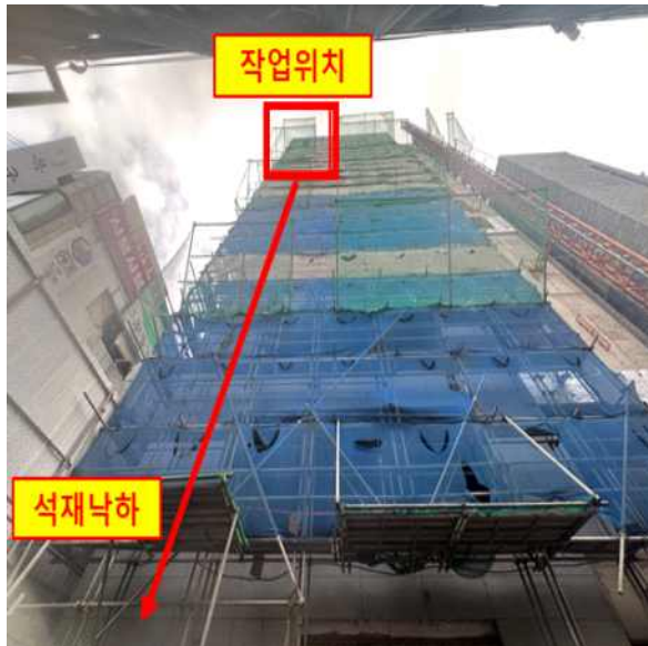
[사진1] 재해 발생구간 전경
