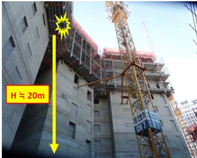
[사진1] 재해발생현장 전경
