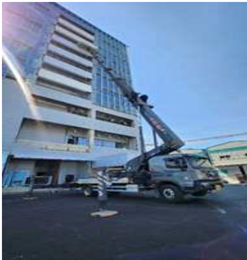
[사진1] 재해발생현장 전경
