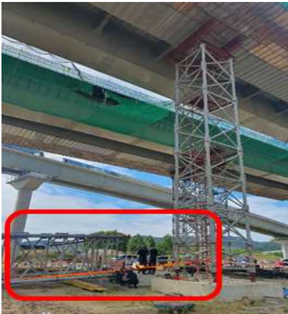
[사진1] 재해발생 장소 전경1
