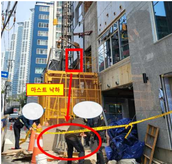
[사진1] 재해발생현장 전경
