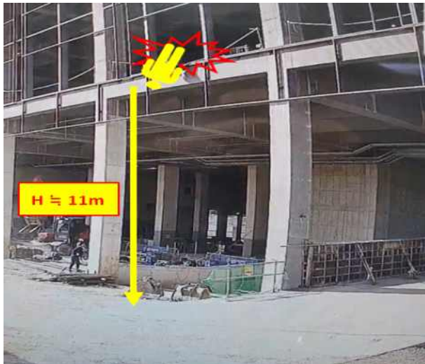
[사진1] 재해발생현장 전경
