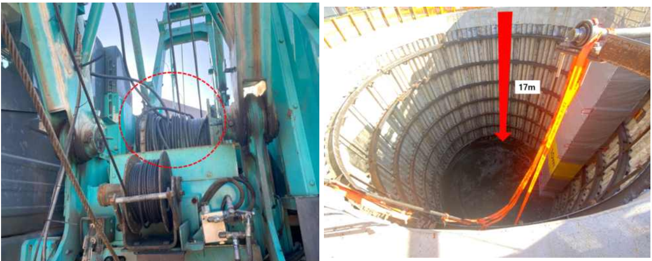
[사진] 재해발생 장소 전경 및 상황도
