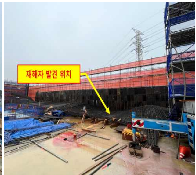
[사진2] 재해현장 전경2
