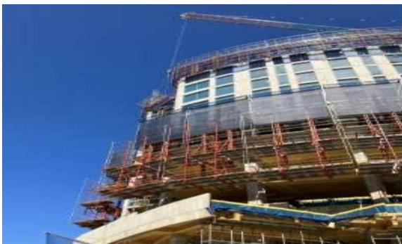
[사진1] 사고발생 장소 전경
