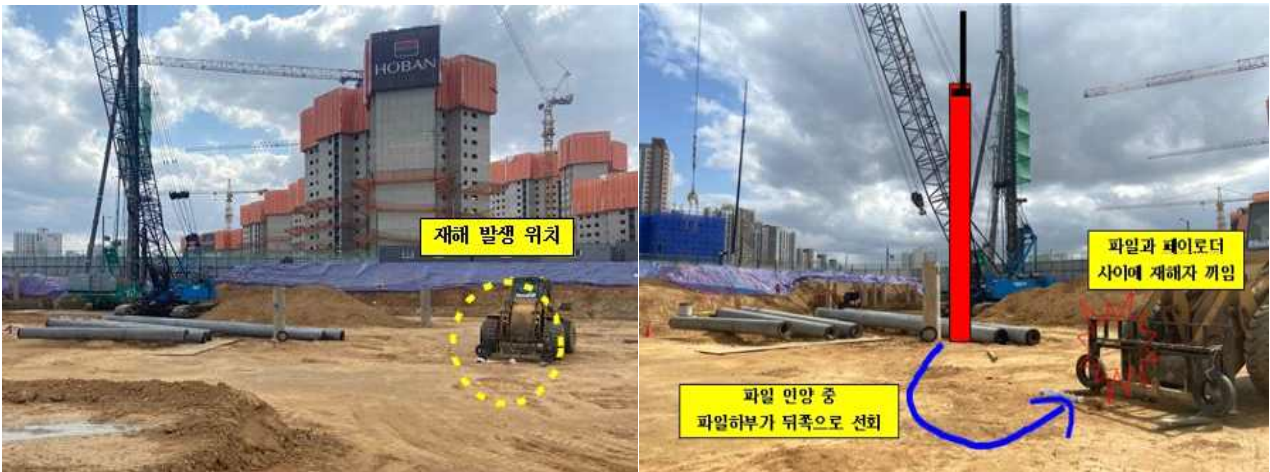
[사진1] 재해발생현장 전경1
