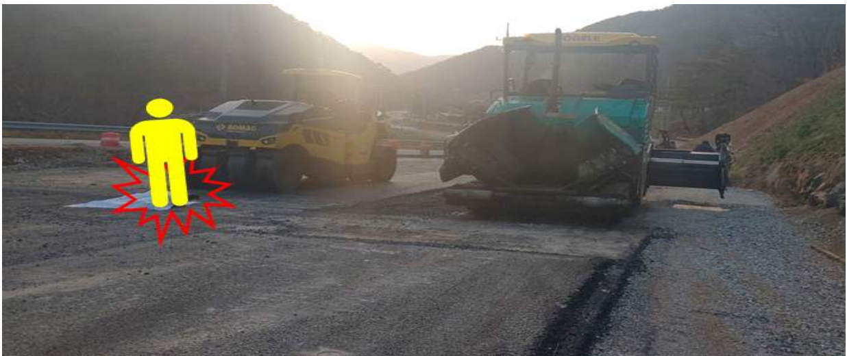
[사진] 재해발생현장 전경
