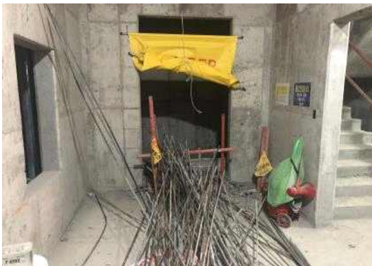
[사진1] 재해발생현장 전경
