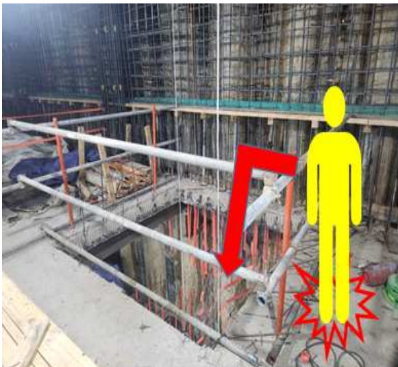
[사진1] 재해발생현장 전경
