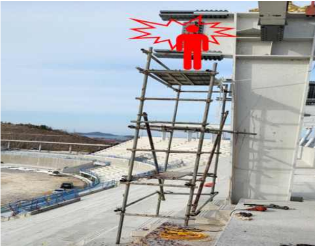
[사진1] 재해발생현장 전경
