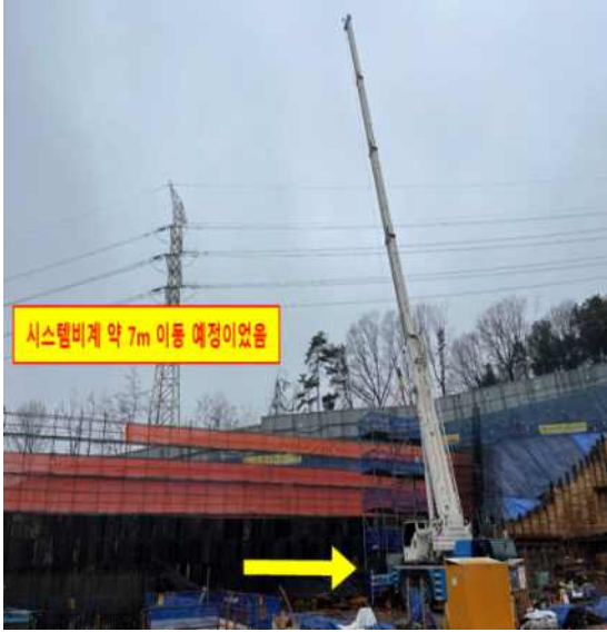
[사진3] 재해현장 전경3
