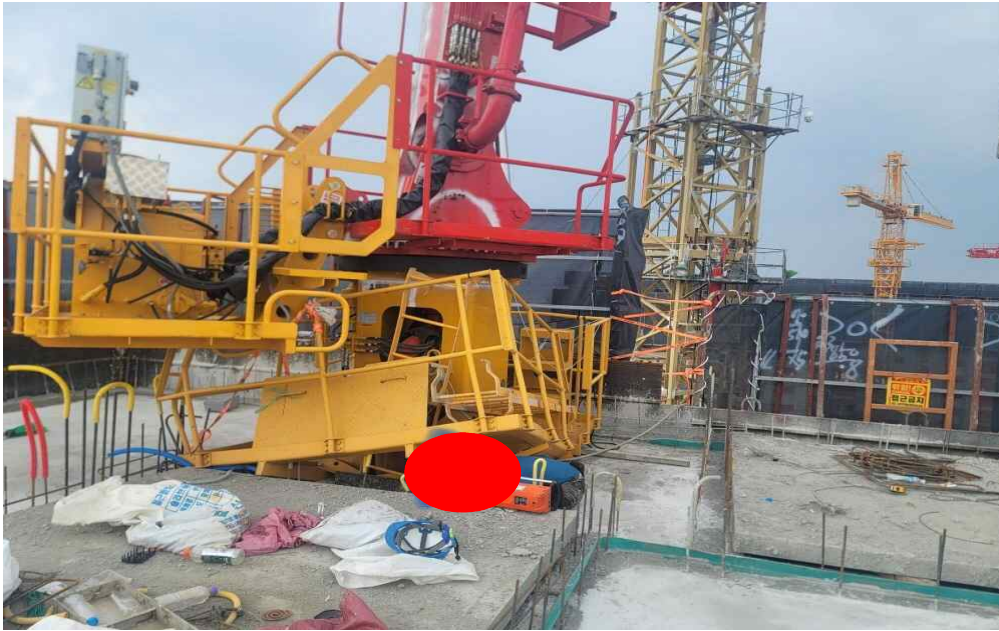
[사진] 재해발생 현장 전경
