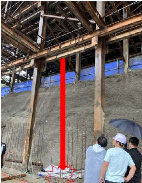
[사진1] 사고 전경
