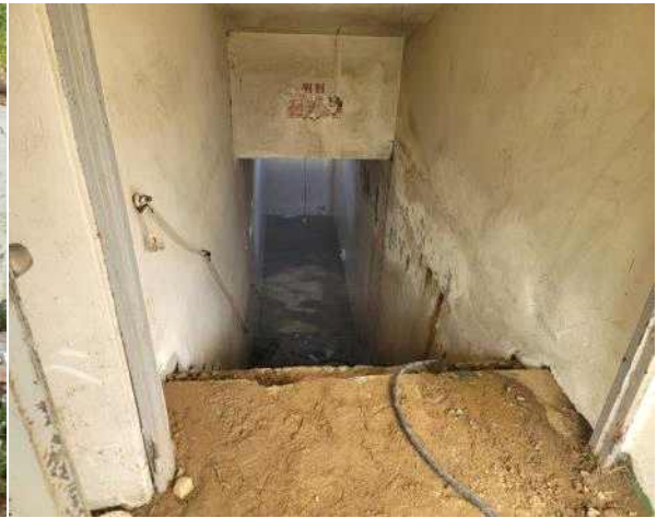
[사진2] 기계전기실 내부
