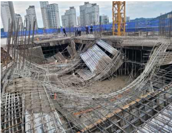
[사진1] 사고발생 장소 전경(9층)
