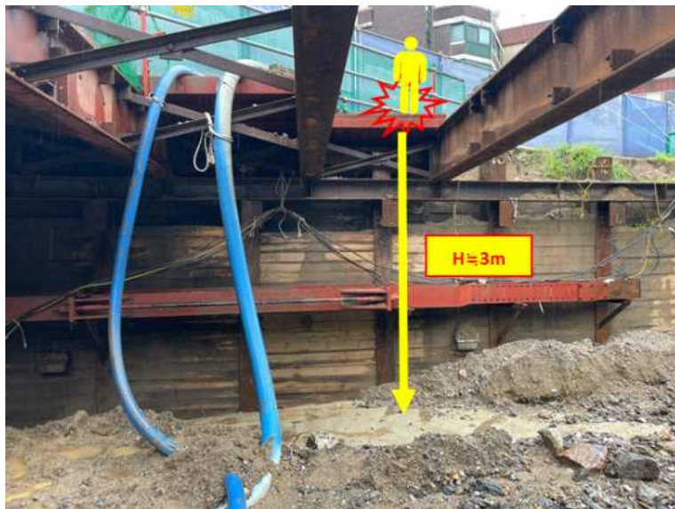
[사진] 사고발생 장소 전경
