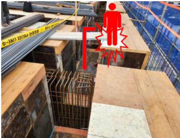
[사진1] 재해발생현장 전경
