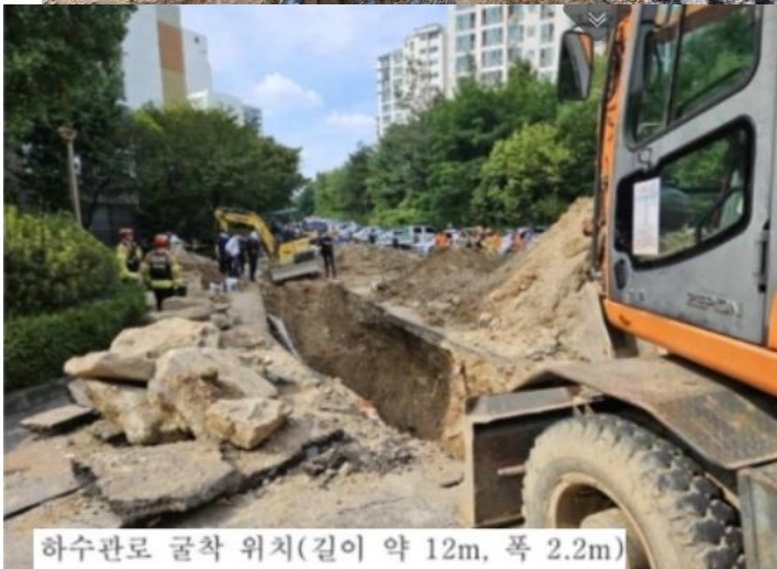
23.9.12.(화) 서울 중랑구 소재 (주)현우이엔씨에서 시공하는 「아파트 생활하수관 맨홀보수와 통수작업, 싱크홀 보수 공사」
