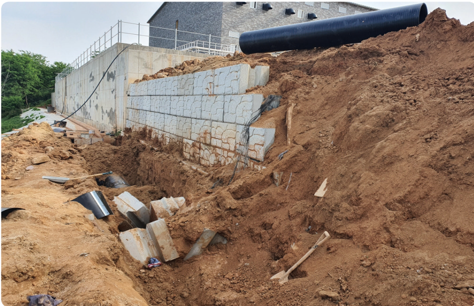
[사진2] 사고발생 직후 붕괴된 보강토 옹벽
