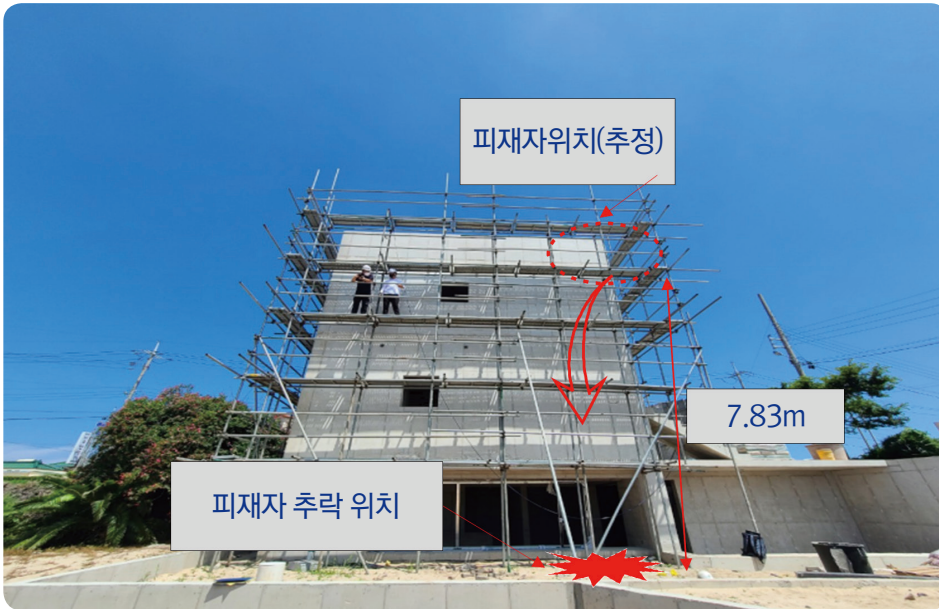
[사진1] 재해발생 현장전경
