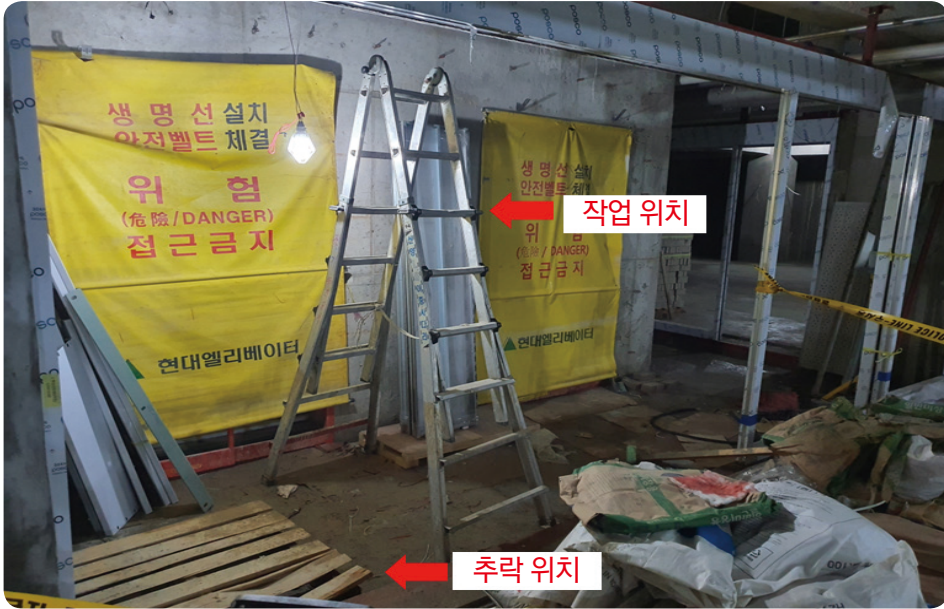
[사진1] 재해발생 현장전경
