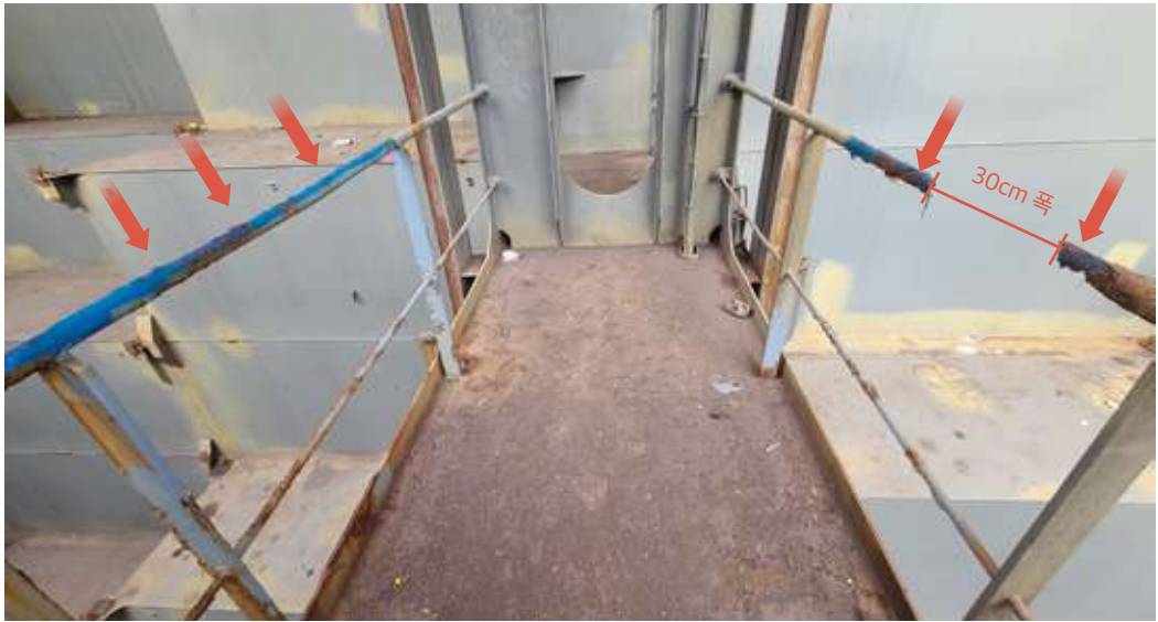
5층 안전난간. 파손된 부분과 재해자가 안전난간 교체를 위해 표시해둔 파란색 페인트 흔적이 보인다
