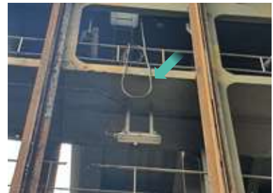
용접 호스가 6층 안전난간 밖으로 걸쳐진 모습
