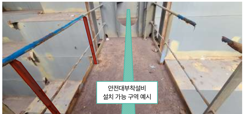
안전난간에 안전대를 걸면 작업하기 불편한 상황이다. 발판 가운데에 안전대부착설비를 설치하는 방안을 고려해야 한다
