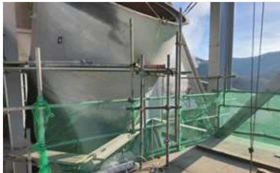
사고 후 안전난간 조치된 재해 현장
