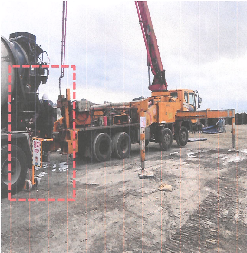
① 협착방지 스토퍼 설치
