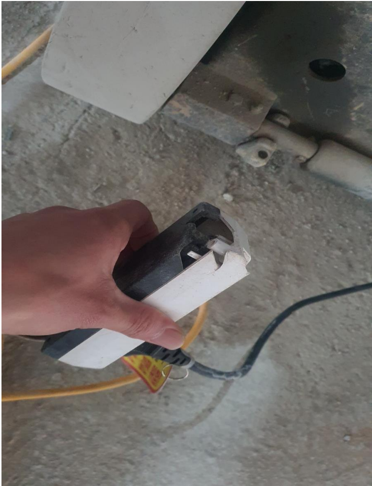
파손된 콘센트 사용 (감전위험)
