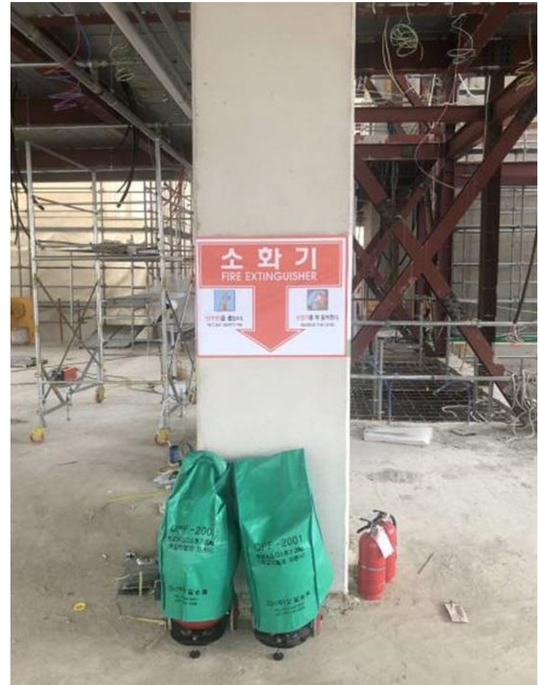
소화기비치 및 소화기 표지 설치 우수
