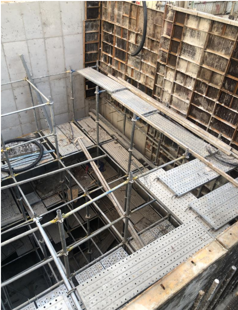
시스템비계 발판 및 안전난간 설치 미흡
