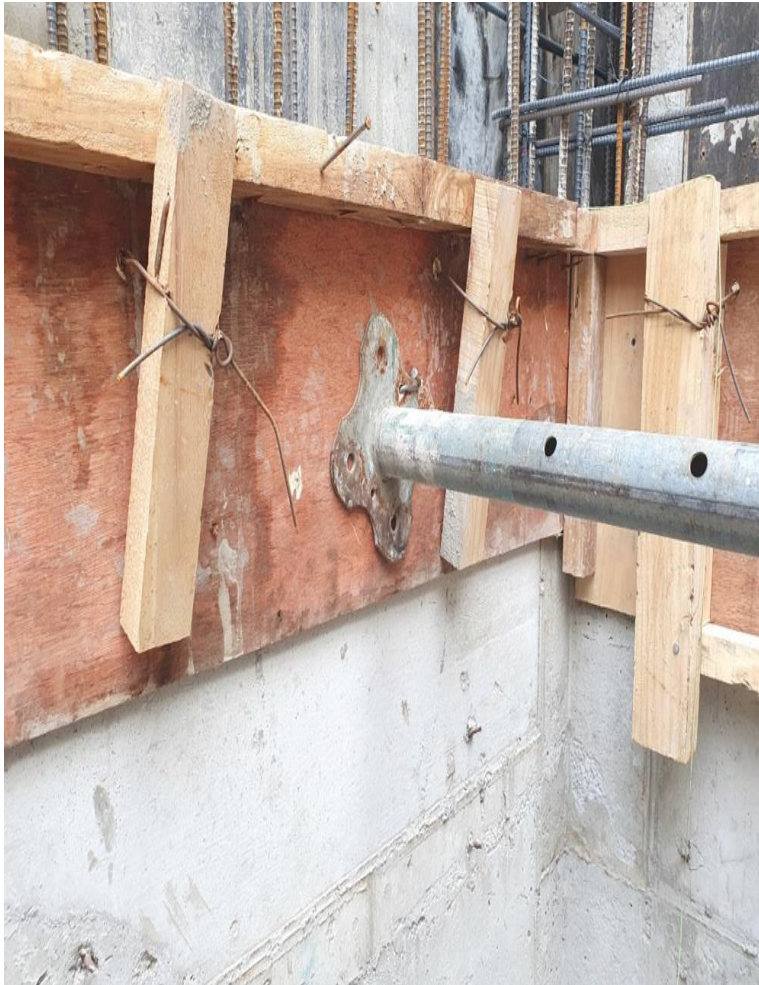
작업발판 거치용 서포트 하부 보강 미 실시
