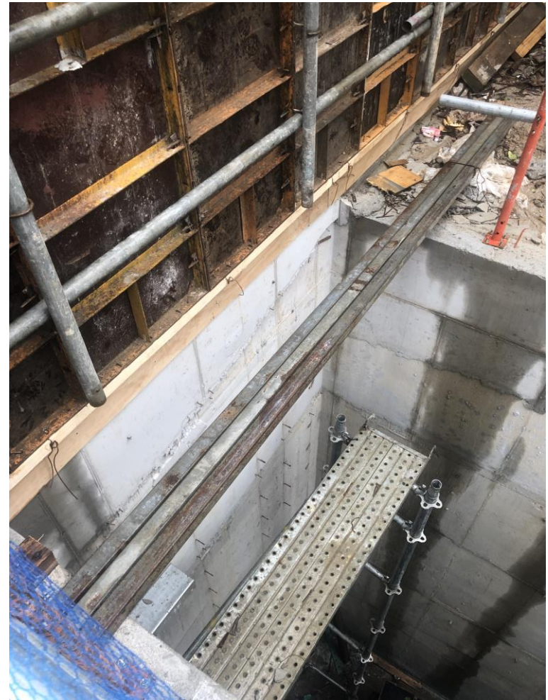
피트구간 발판 및 안전대 걸이시설 미설치
