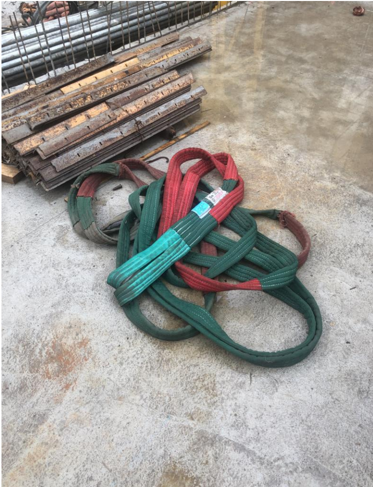
슬링벨트 보관함 미설치 (슬링벨트 현장 방치)
