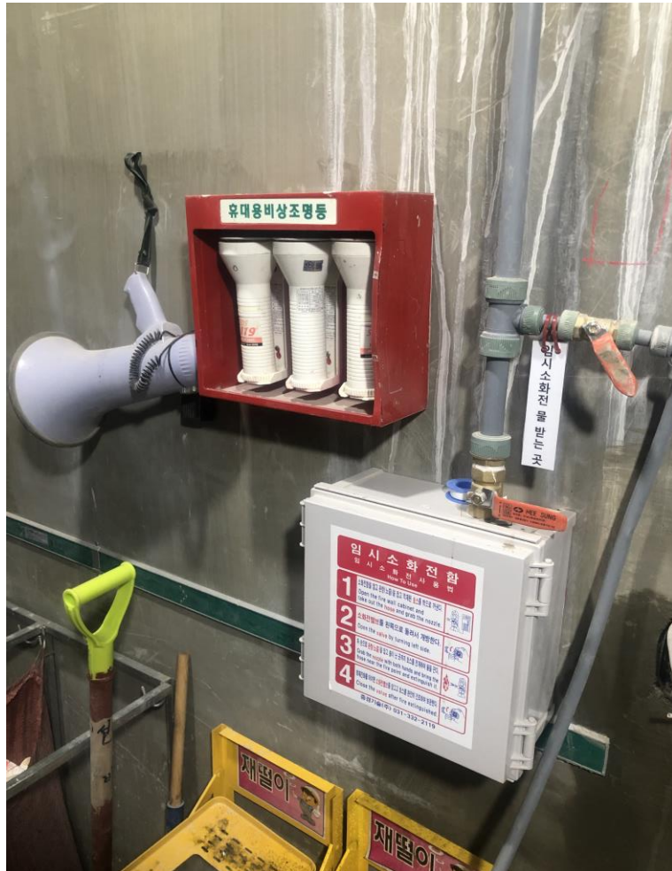
임시소방시설 설치 우수
