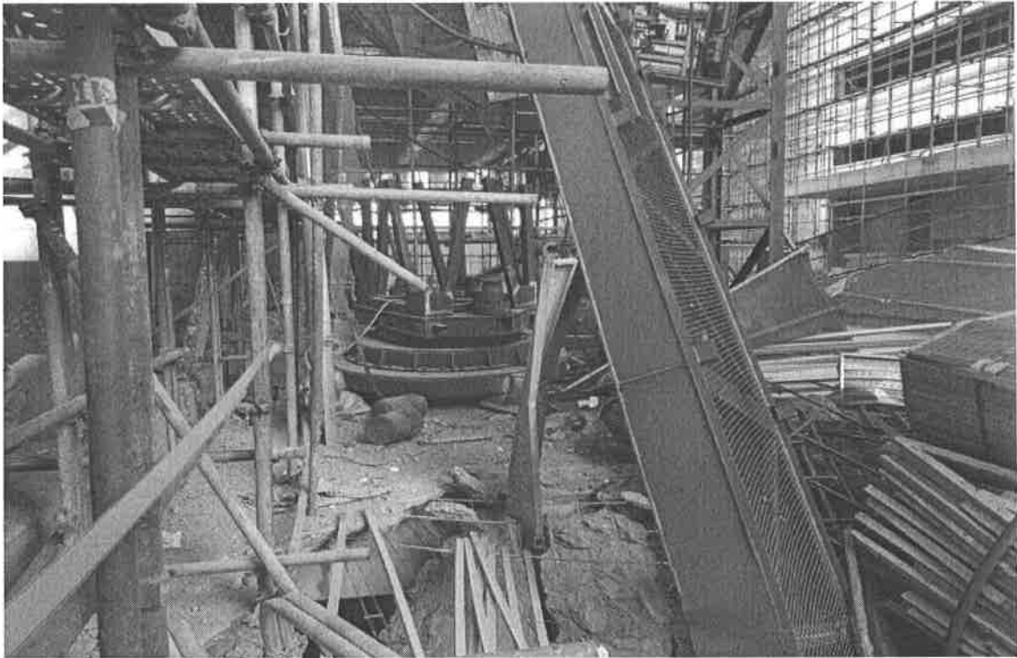
사고 사진 사고현황(하부)
