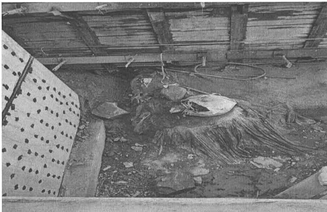
사고 사진 사고현황(호박돌 낙하부 전경)
