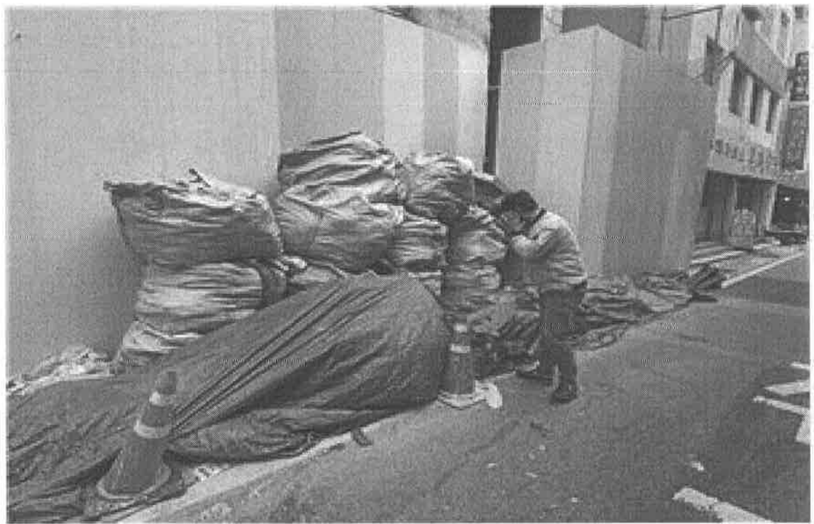
사고 사진 사고현황(낙하물 낙하 위치)
