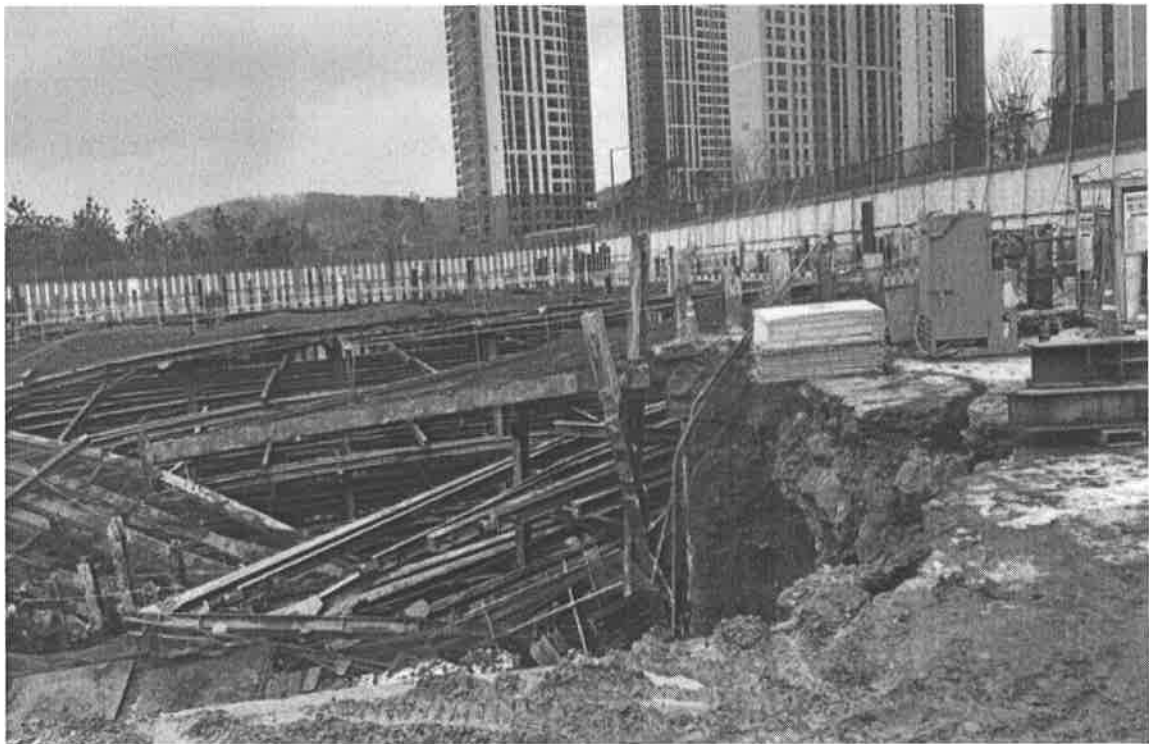
사고 사진 사고전경(근경)
