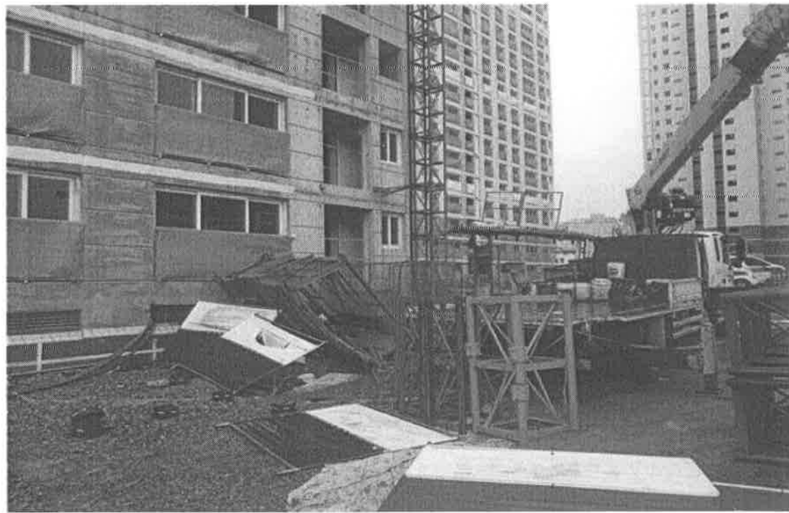
사고 사진 사고현황(호이스트 케이지 추락전경)
