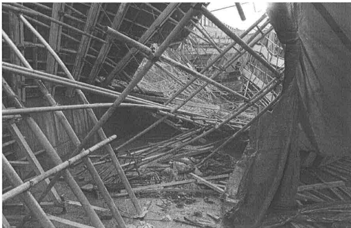
사고 사진 사고현장 전경(근경)
