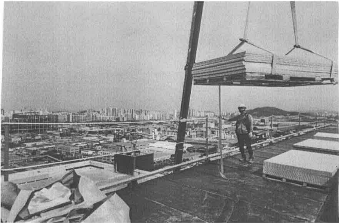
사고 사진 사고현황(준공전 안전난간 설치전경)
