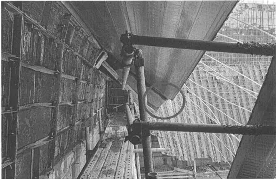
사고 사진 사고현장 현황(철골빔 파단 부위)
