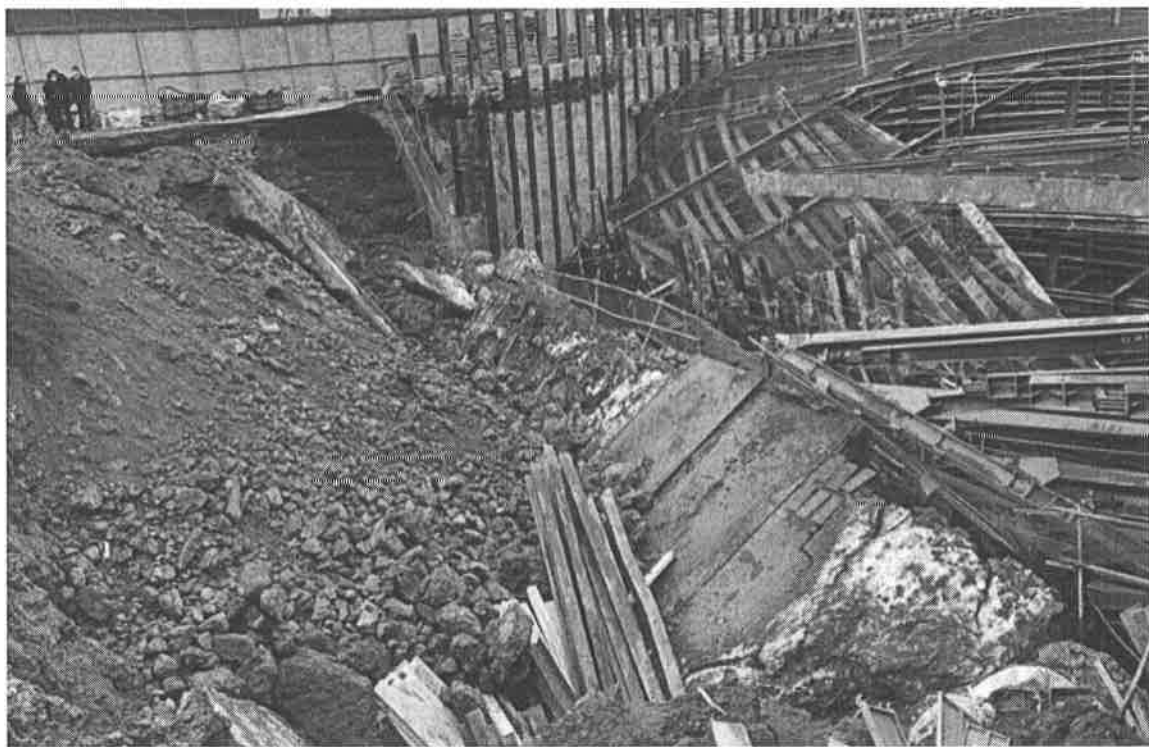
사고 사진 사고전경(근경)
