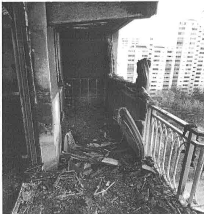
사고 사진 사고현황(세대 베란다 전경)
