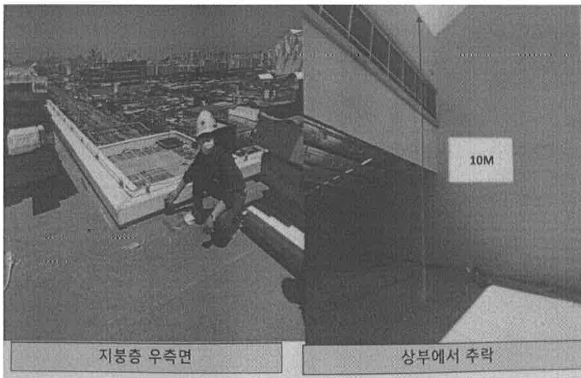
사고 사진 사고현황(지붕층 위치 및 추락 경로)
