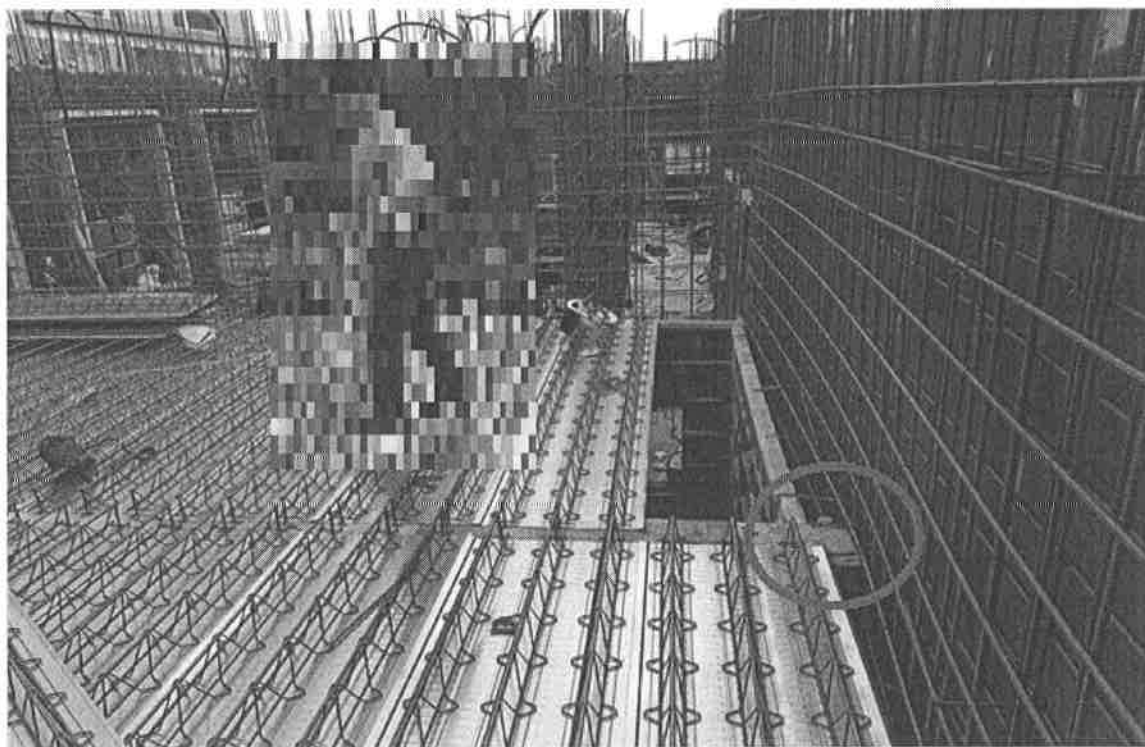
사고 사진 사고현장 철골빔 벽체철근 용접현황
