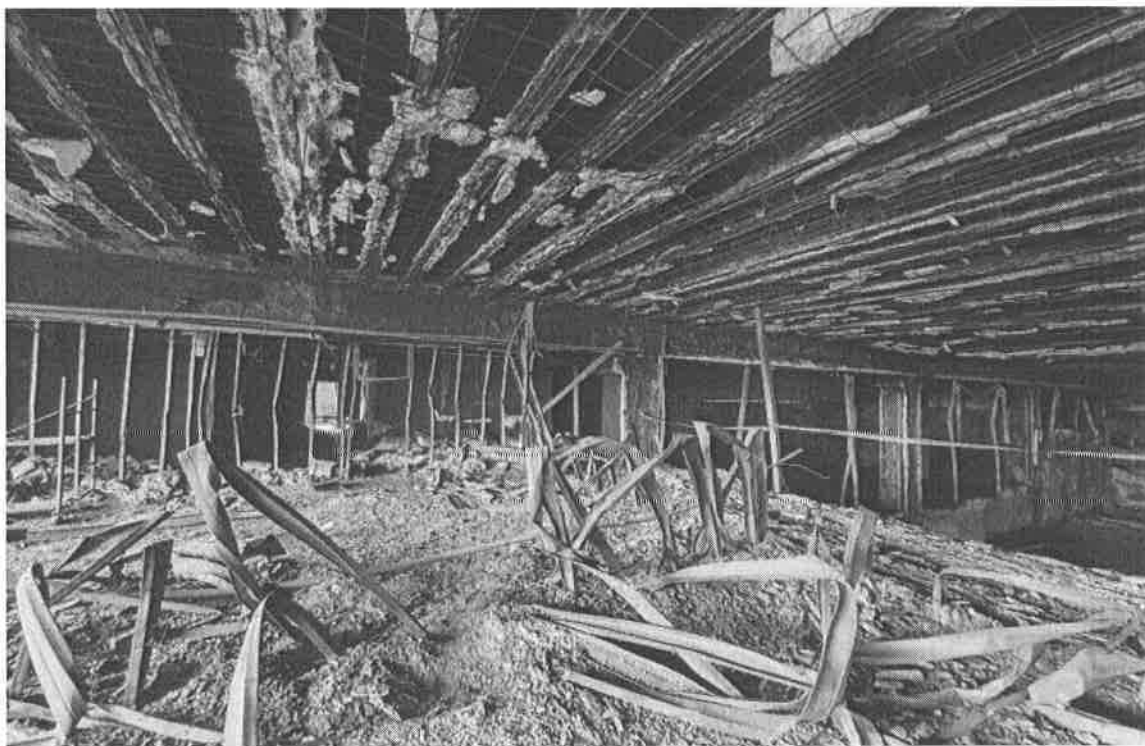
사고 사진 사고현황(내부 천정 및 벽체 전경)
