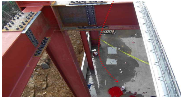
데크 설치 중 5m 아래로 떨어져 2명 사상('15.11.14, 경북 구미)
