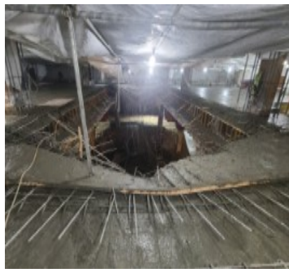
재해발생 구간 전경
