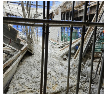
재해발생 구간 전경
