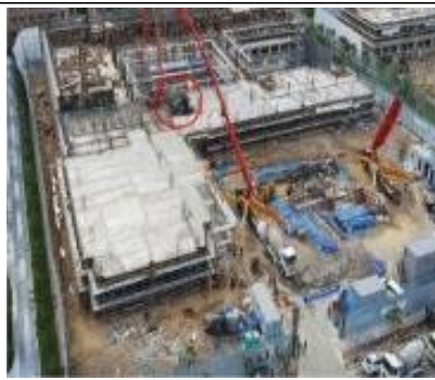
재해발생 현장 전경
