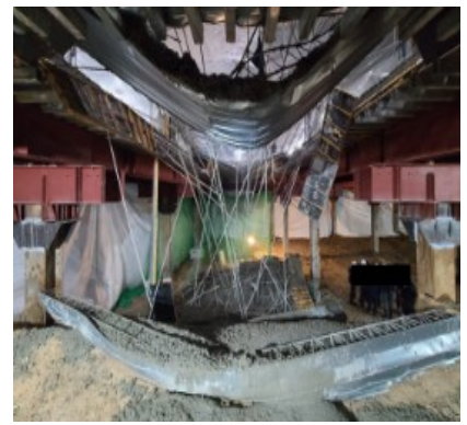
재해발생 구간 하부 전경
