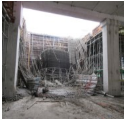
재해발생 현장 전경
