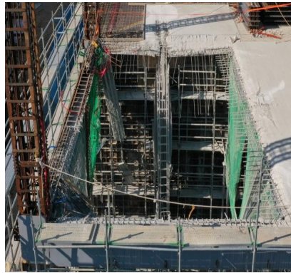
재해발생 현장 전경
