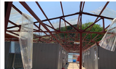
사고발생 현장 전경
