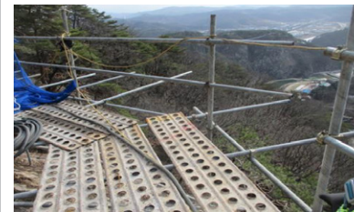
사고발생 현장 전경
