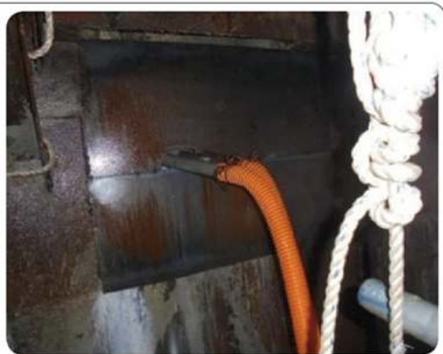
흙막이벽체 구멍 발생 부위 보강 현황(10.12)
