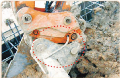
3 버킷 유압 커플러 안전핀 부적합(철근사용)
