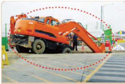
2 굴착 깊이 장비 제원 초과
