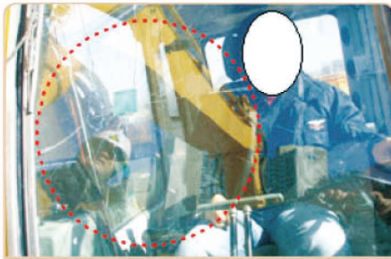
3 운전석 전면 유리 파손
