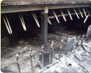
지수판 용접 중 하부 우레탄보온판 화재로 4명 사상
