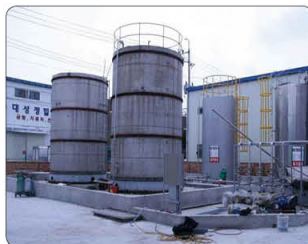
구 톨루엔 저장탱크 이전 설치 용접 중 폭발로 2명 사망
