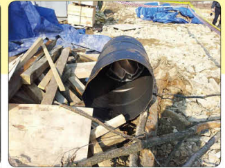
화목난로용 페드럼통 용단 작업 중 폭발로 1명 사망
