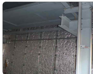
주차타워 내부 용단 중 폴리에틸렌 단열재 화재로 3명 사상
