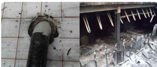
지수판 용접 중 하부 우레탄 보온판 화재로 4명 사상
