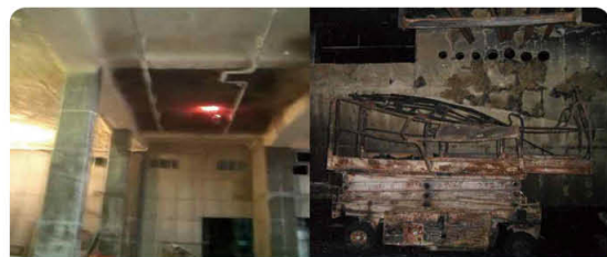
가설전등 스파크로 인한 우레탄폼 화재로 13명 사상
