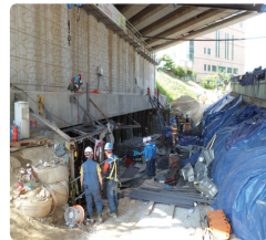
북선전철 교량 하부보강 중 LPG폭발 ('16. 6. 1 사망4, 부상10)
