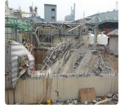
페루 환경설비 구축공사 중 폭발 ('15. 7. 3 사망6, 부상1)
