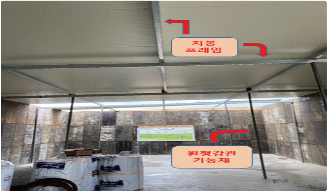
[사진1] 재해발생 현장전경
